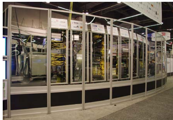
図6：SCinet接続設備。関連企業から機材の提供を受けて運営されている。
